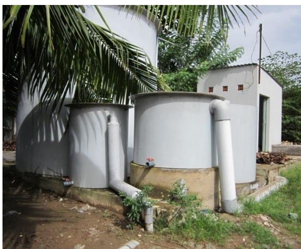
Hình 5: Hệ thống xử lý nước thải chợ thị trấn Giồng Trôm
